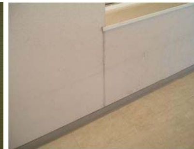
壁面クラック(補修前)
