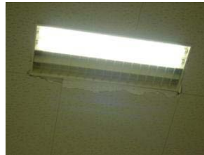
天井部照明器具(補修前)
